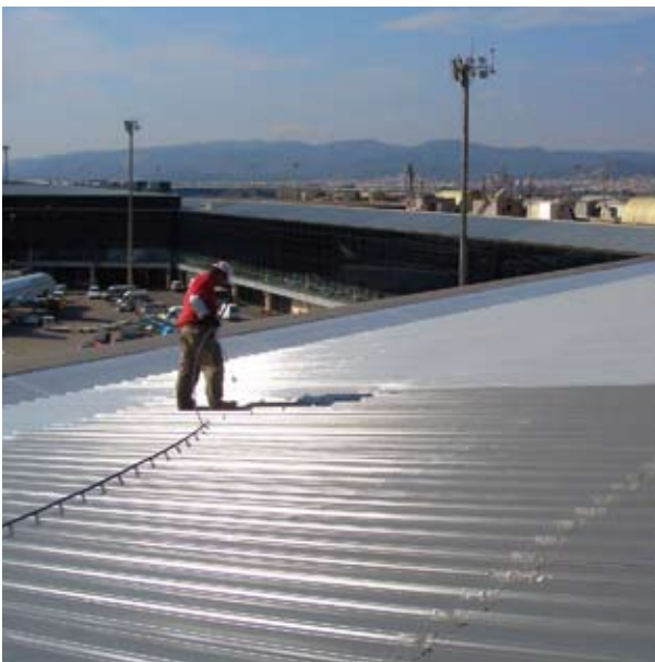
Los sistemas impermeabilizantes se han usado en varios aeropuertos
