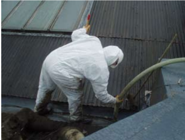
Las aguas de limpieza se bombean hasta una unidad de filtración
